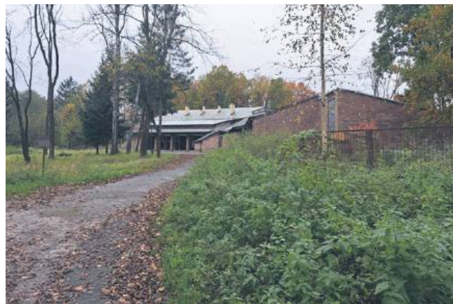
Budynek potrzebuje gruntownego remontu.
