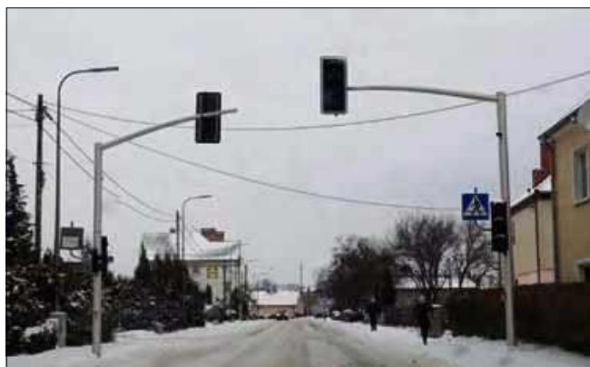
Urządzenie już jest zamontowane.
