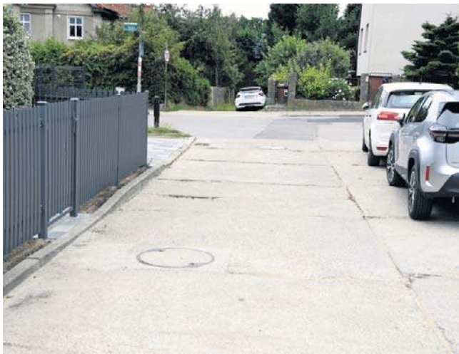
Pękające betonowe płyty i zapadająca się jezdnia – zdaniem mieszkańców stan ul. Siewnej z miesiąca na miesiąc się pogarsza
