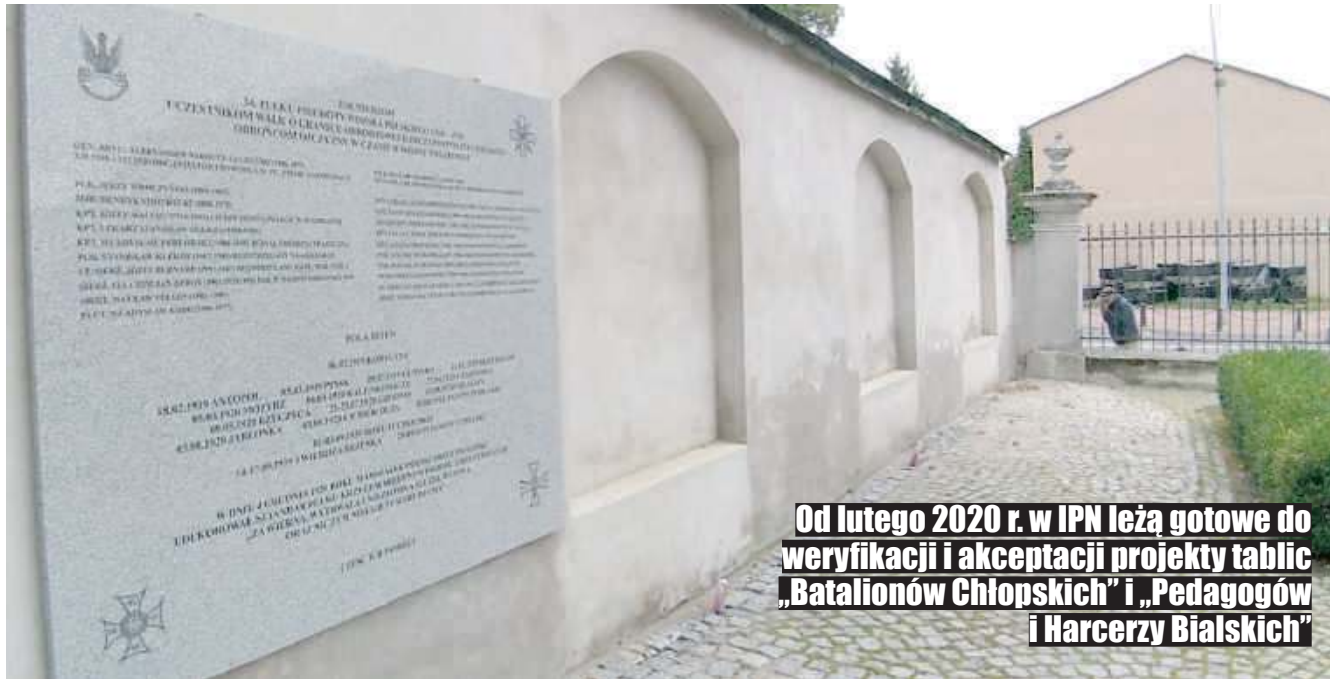
Na murze ogrodzenia klasztorowego wisi tylko jedna tablica. Widać miejsca zawilgocone
