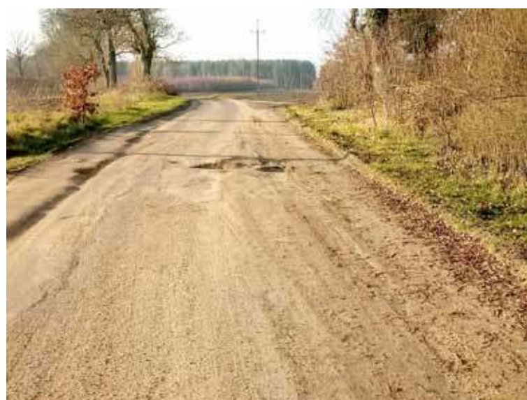
Dojazd do wsi zapewniają także tzw. polne drogi, które jak widać również są mocno zniszczone.
