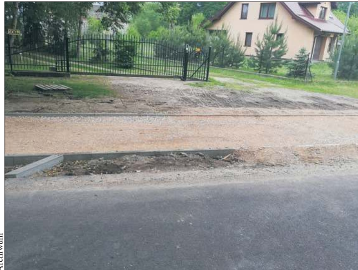
Na odcinku leśnym nie ma wybudowanych podjazdów
