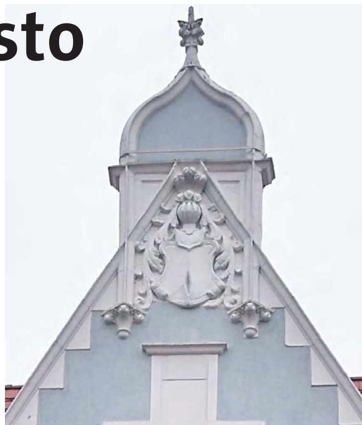
Jury konkursu przy ocenianiu brało pod uwagę m.in. dochowanie staranności w odtworzeniu detali architektonicznych.
