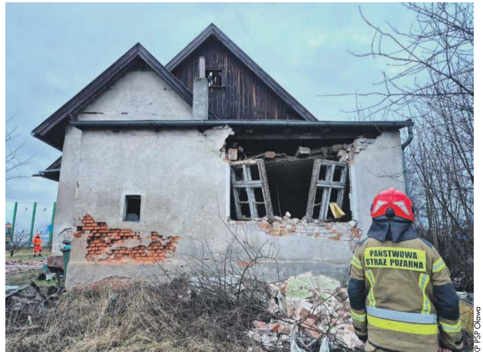
Wybuch naruszył ściany nośne budynku, a niektóre są całkowicie zniszczone
