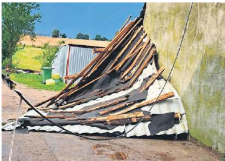
Różne elementy dachu rozpadły się na podwórku.
