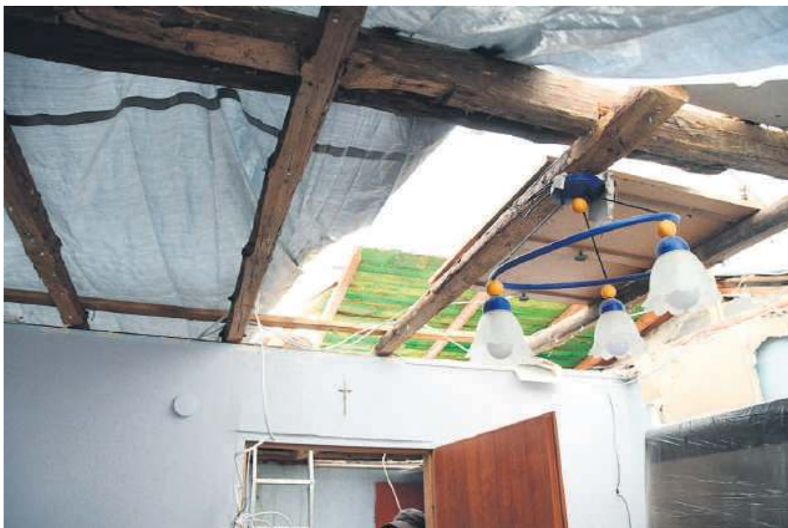
Zerwany dach domu rodziny Przybylskich to zdecydowanie najpoważniejsze zniszczenia po ubiegłotygodniowej burzy.
