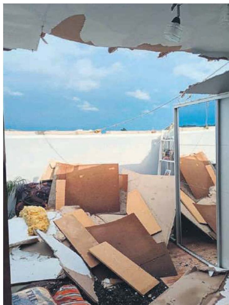
Zniszczone piętro domu mieszczącego się we wsi Pod Komorzą, na wybudowaniu, wokół którego są pola.
