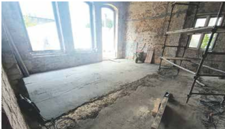
Wnętrza budynku trzeba całkowicie przebudować
