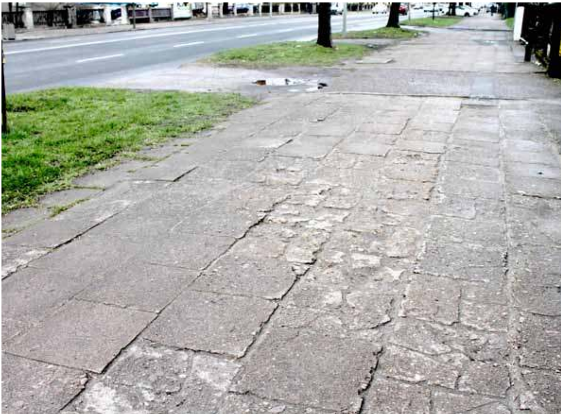
Chodnik na Szczecińskiej, na odcinku od Poczty w stronę stacji paliw, jest miejscami w złym stanie
