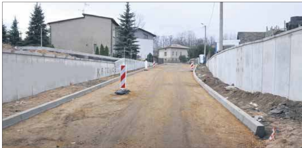
Za przejazd utwardzonym odcinkiem drogi kierowcy byli karani mandatami
