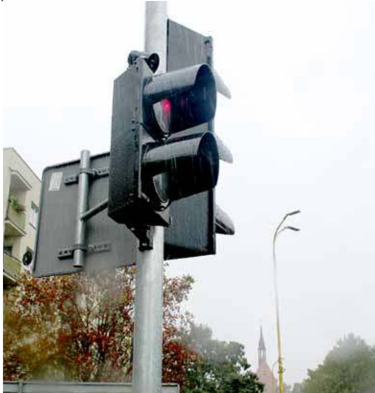
Brzęczki zamontowano, ale na razie słabo je słychać, a niekiedy nie działają wcale
