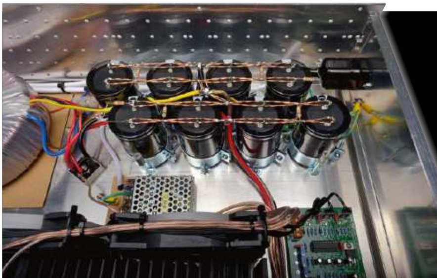
Celem zapewnienia bezpieczeństwa, bateria kondensatorów wymaga zamontowania na niej arkusza Perspex zapobiegającego przed przypadkowym kontaktem z szyną zasilania. Zdjęcie przedstawia kondensatory bez osłony wyraźnie pokazujące ich rozmieszczenie
