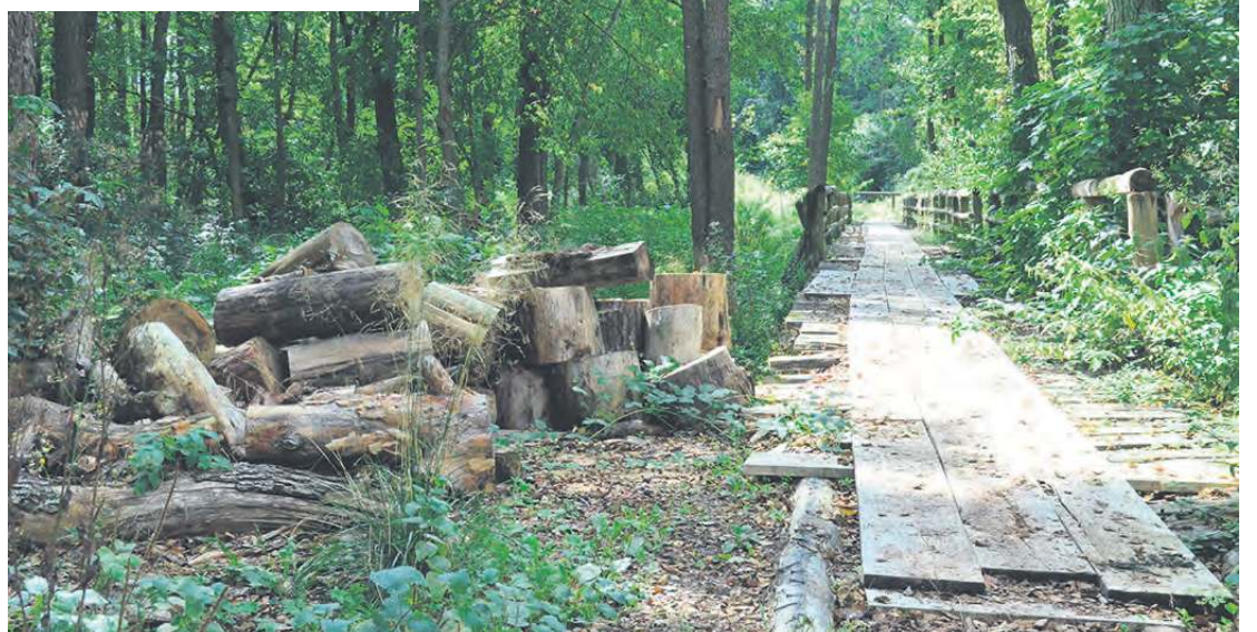
Pozostałości drewna po porządkach i wzmocniona deskami, ale nadal niestabilna konstrukcja mostu.
