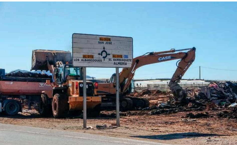
Koparki porządkują zgłiszcza El Walili dzień po pożarze, 31 stycznia 2023 r.
