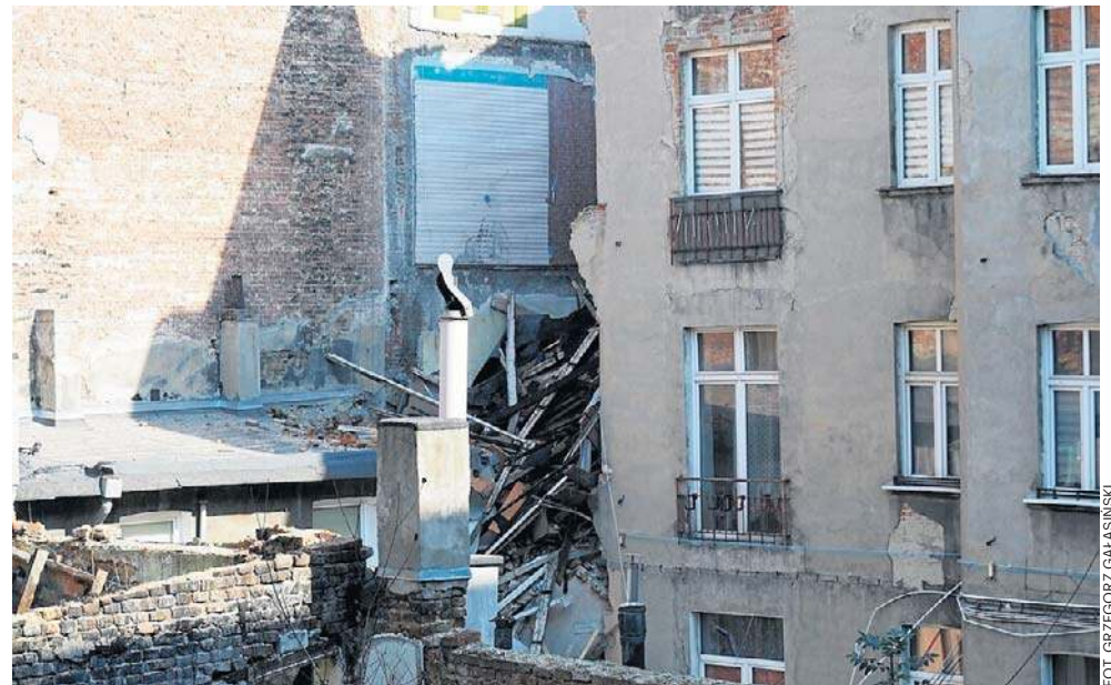
Część kamienicy przy al. 1 Maja 23 zawaliła się podczas drażenia tunelu kolejowego pod budynkami. Mieszkańcy już raczej nie wrócą do swoich domów
