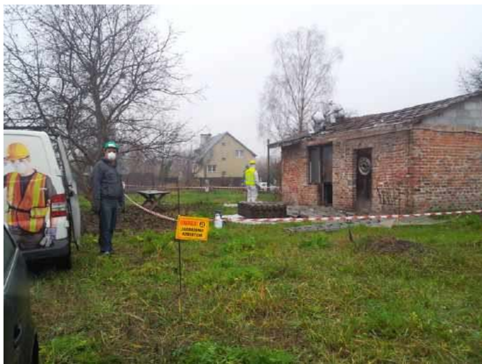
❗ Miejsce, na którym usuwany jest azbest, powinno być ogrodzone taśmą i oznakowane. RAMID
