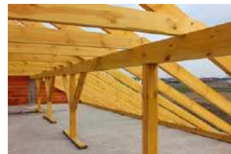
📍 Słupy, które występują w konstrukcji płatwiowo-kleszczowej, utrudniają zagospodarowanie poddasza.
