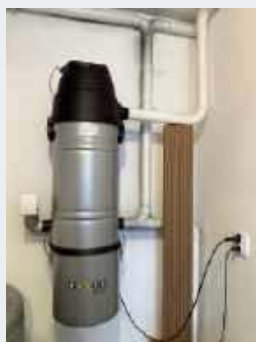
🔧 Jednostka centralna z multifiltrem wisi na wewnętrznej ścianie kotłowni.
