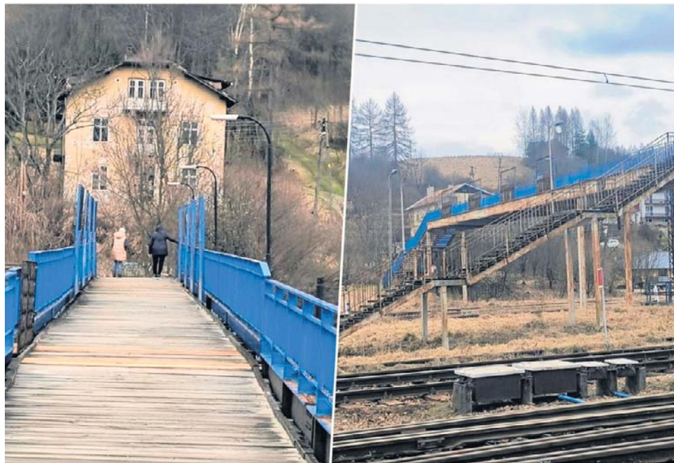
Doraźne remonty obiektu wykonuje gmina, choć nie jest on własnością samorządu
