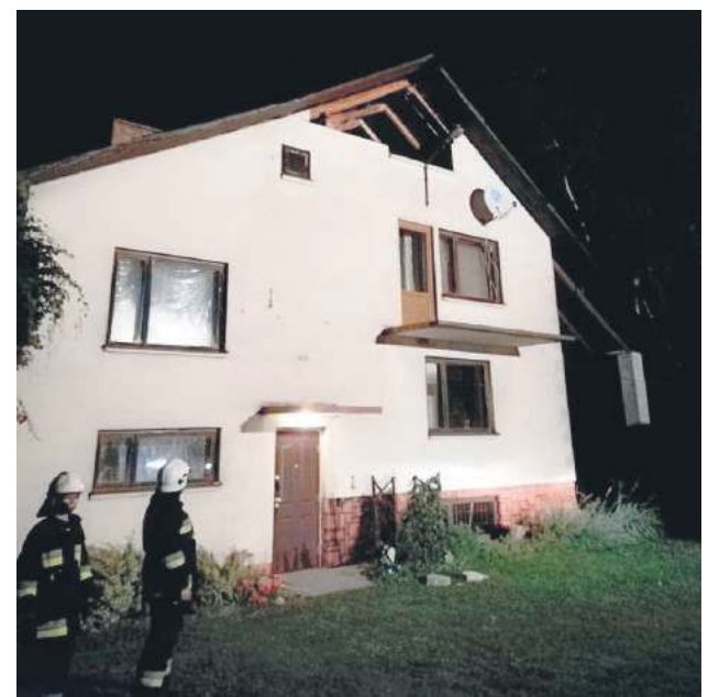
Zerwany dach na jednym z domów. Fot. PSP w Zamościu
