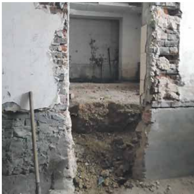
Skala prac w zabytkowych wnętrzach przeraża konserwatorów - tu pogłębione piwnice.
