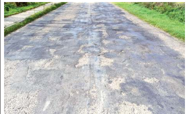
Tak aktualnie wygląda droga powiatowa w Łąkoci, na jednym z odcinków zakwalifikowanych do remontu
