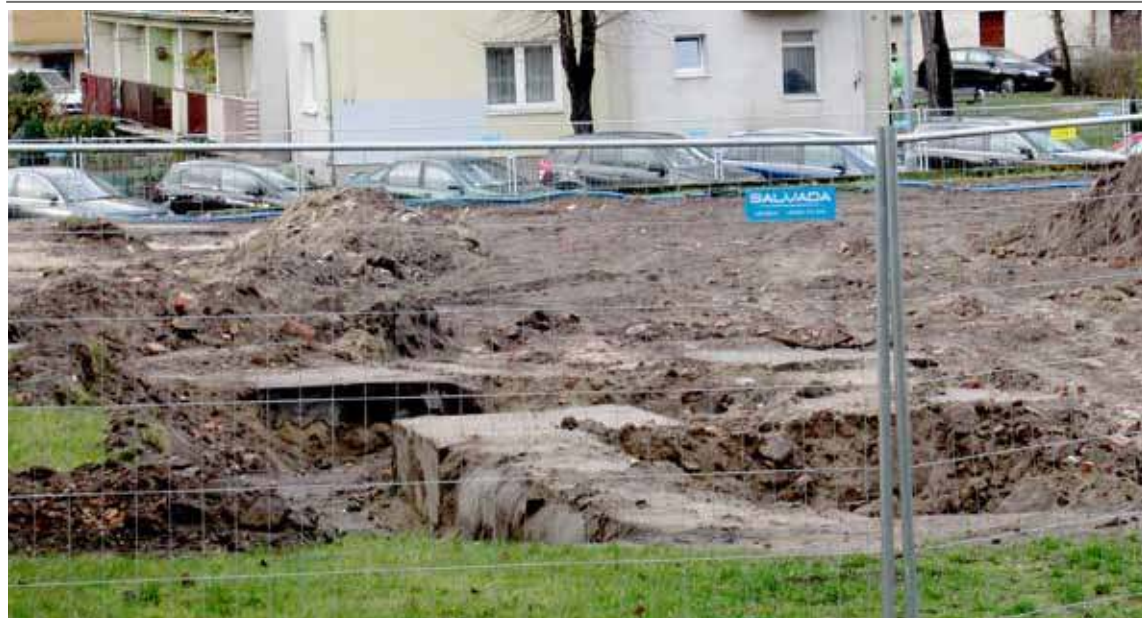
Piwnice, które zatrzymały budowę
