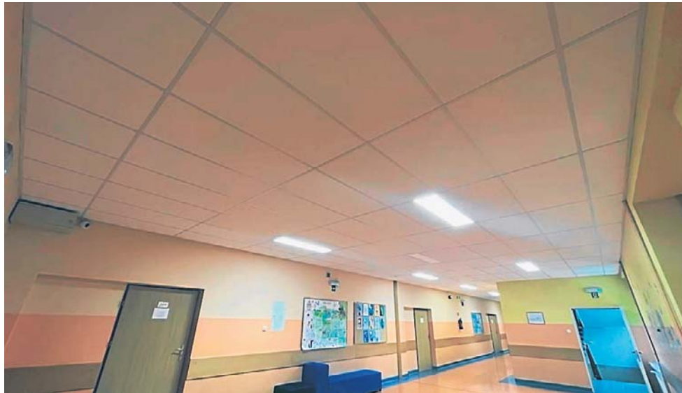
W ramach RBO rodzice chcą pozyskać 400 tys. zł na montaż paneli pochłaniających dźwięk. Tak wygląda sufit dźwiękochłonny w szkole w Wyrach
