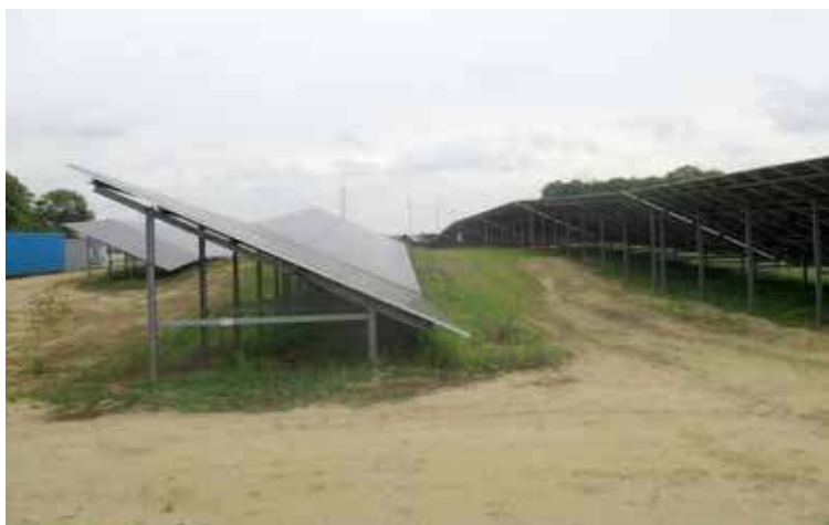
obiekty o mocy 1MW każda.
