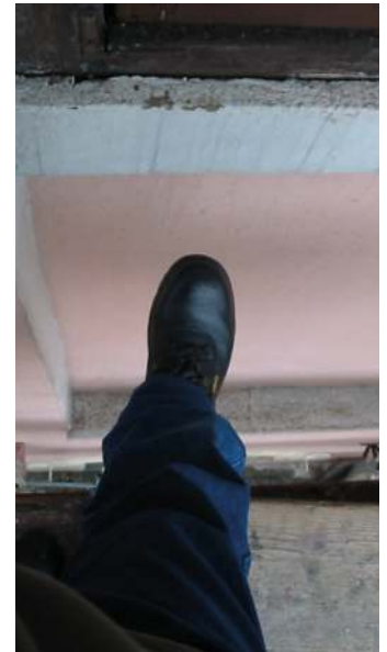
Rys. 2. Brak zabezpieczenia balustradami przy wewnątrz obiektu [12]
