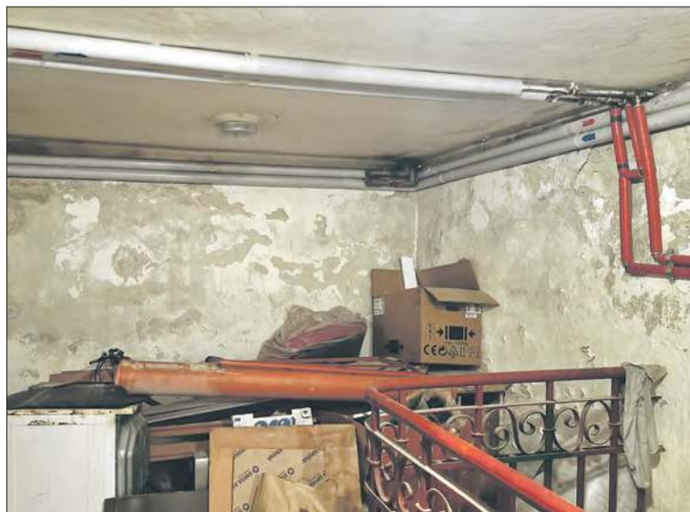
Zawilgocone ściany wewnątrz budynku
