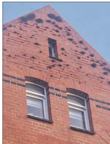
Mech porastający elewację budynku
