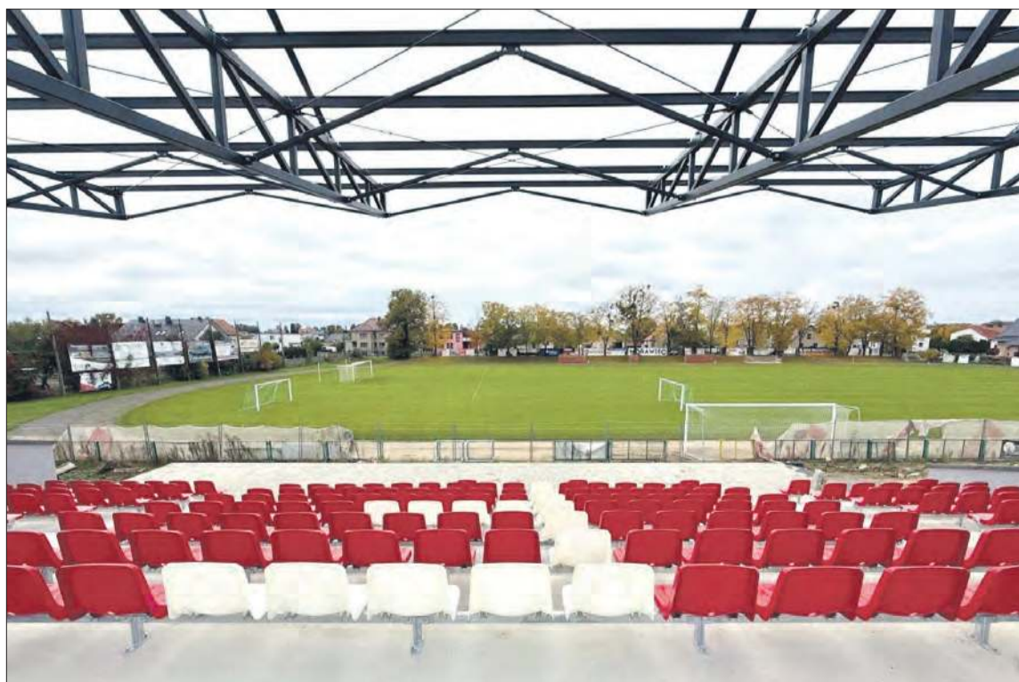
Stadion Miejski w Głogówku nabiera nowych kształtów. Prace idą pełną parą – zarówno wewnątrz budynku, jak i na trybunach. Kibice Fortuny i Rolnika nie mogą doczekać się finału. (ws)
