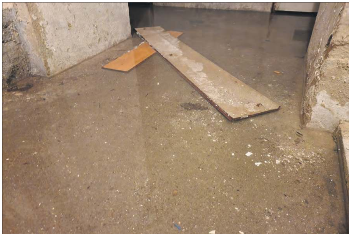
Woda w piwnicy
