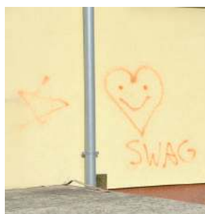
Zniszczona elewacja budynku remizy OSP w Łaziskach
