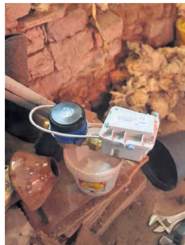
Liczniki przedpłatowe to dobre rozwiązanie wobec tych, którzy nie chcą płacić za wodę. Zdjęcie poglądowe
