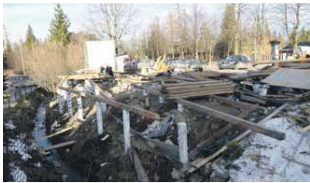
Halny wybitnie pomógł w rozbiorce samowolnie ustawionych pod Wielką Krokwią kramów, ale nowe już rosną na betonowych palach.
