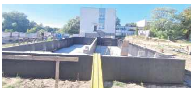
Do istniejącego budynku szkoły dobudowane zostanie wschodnie skrzydło składające się z dwóch części – Klubu Dziecięcego i łącznika. Nowy obiekt będzie jednokondygnacyjny, nowoczesny i w pełni dostosowany do potrzeb najmłodszych dzieci
