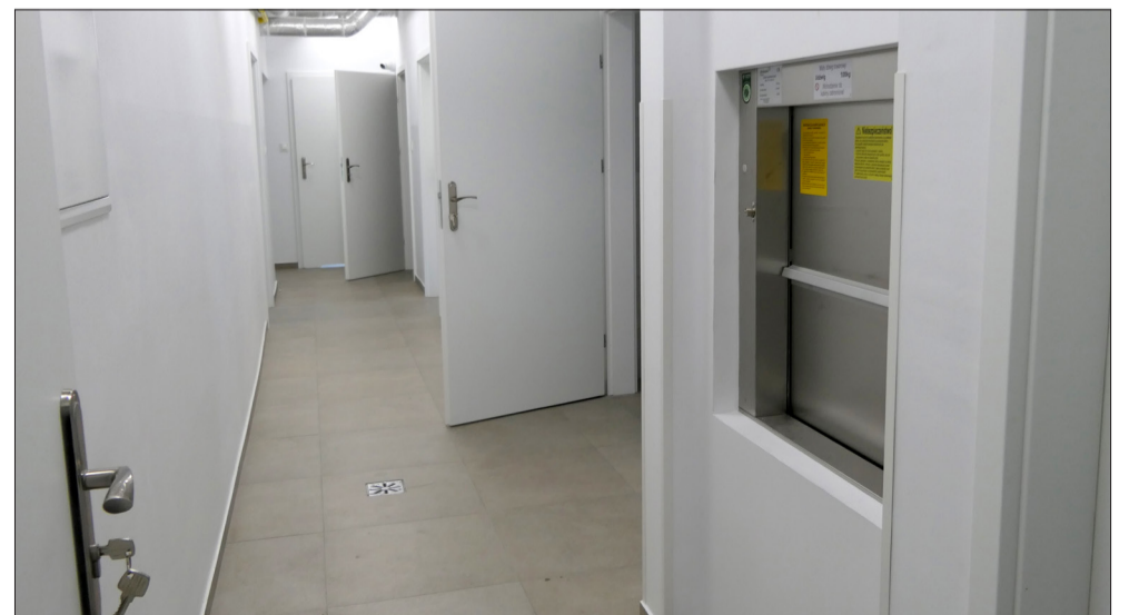
Nowo wybudowana winda towarowa ułatwi transport produktów i sprzętu między pomieszczeniami, zapewniając wygodę i bezpieczeństwo użytkownika.
