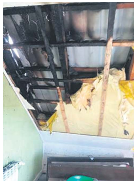
Druhowie z Bysławia tłumaczą, że trudność podczas gaszenia polegała na tym, że ogień umiejscowiony był pomiędzy dachem a podbitką. Fot. OSP Bysław
