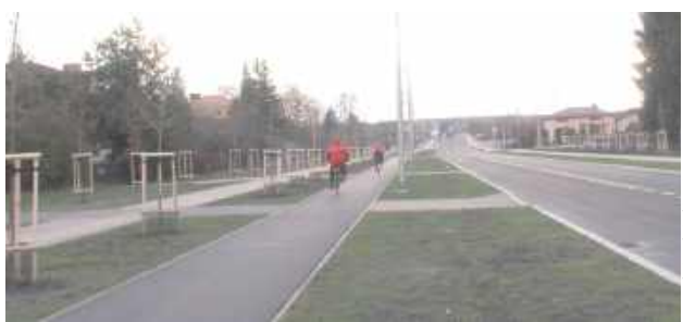
Ścieżka rowerowa szeroka na 2 m na Al. Riada Haidara nagle zaczęła w niektórych miejscach pękać i się załamywać
