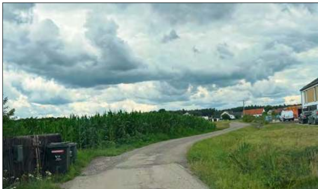
Zdaniem interweniującego ulica Łkowa w Gwoźdżicach wymaga uzupełnienia i wyrównania, a także umocnienia poboczy.
