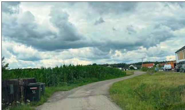
Zdaniem interweniującego ulica Łkowa w Gwoździcach wymaga uzupełnienia i wyrównania, a także umocnienia poboczy.
