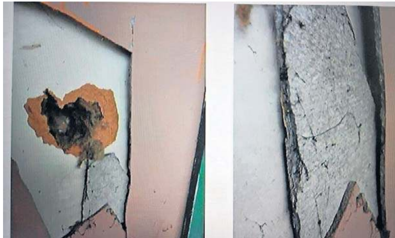
Zdjęcia azbestu odkrytego wewnątrz ścian w budynku przedszkola
