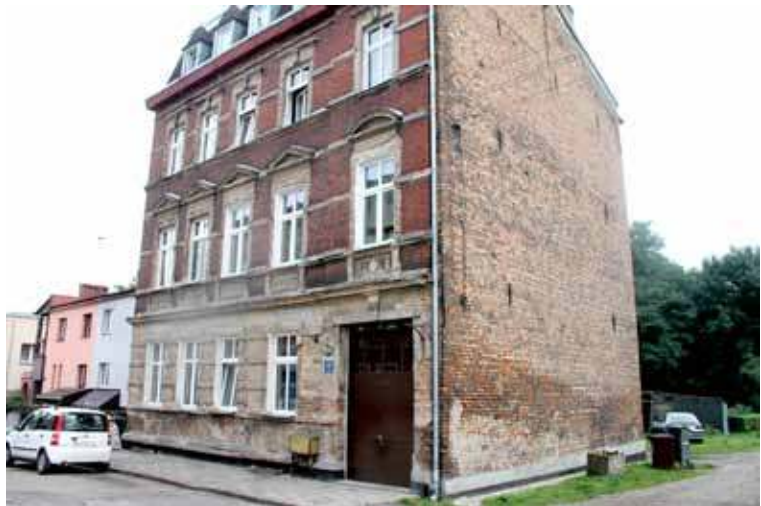
Mieszkańcy pytają, czy jest planowany remont elewacji tego budynku wraz ze ścianami bocznymi, które mają odsłonięte cegły
