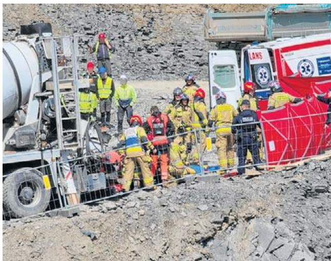
W wyniku wypadku na budowie 30-latek stracił jedną nogę, a drugą ma poważnie złamaną
