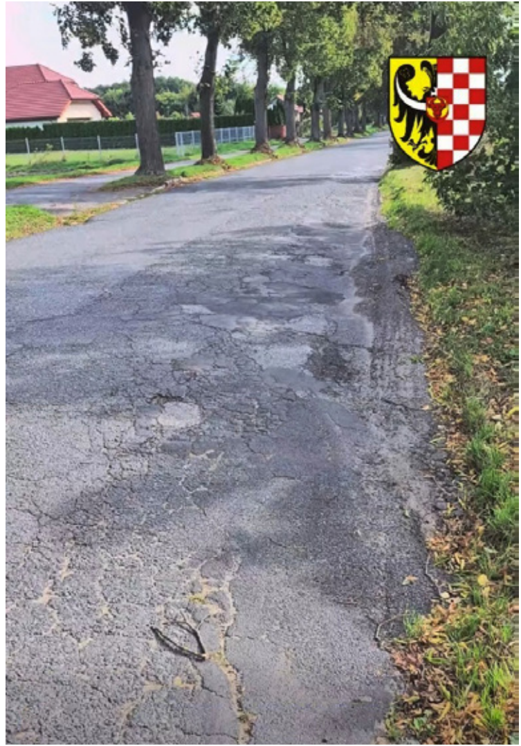
Ul. Willmana w Lubiążu przeznaczona do remontu.
