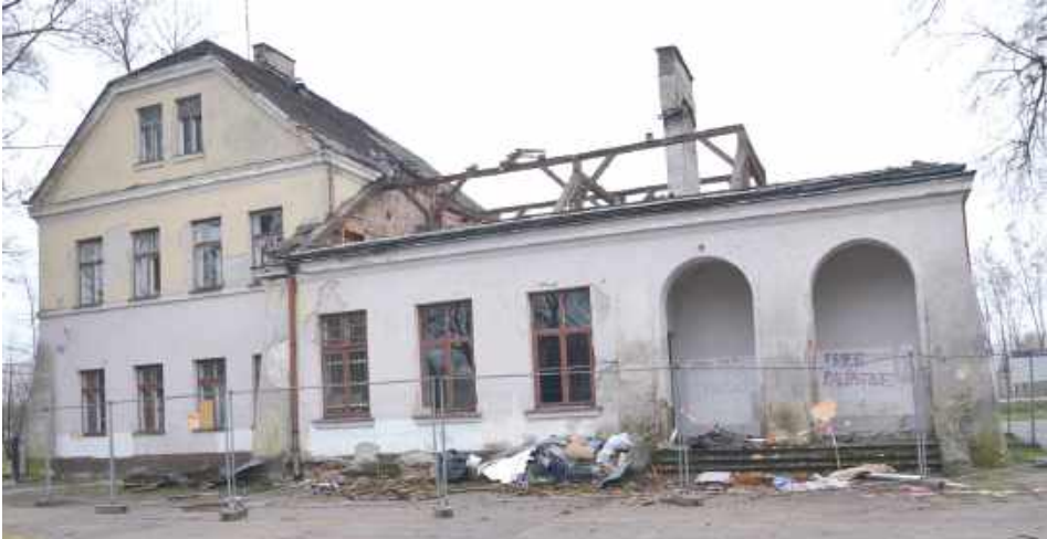
1993 roku stacja kolejowa Leopoldów została zamknięta. Od tego czasu zaczął się powolny okres degradacji tego budynku, chociaż zaraz po zamknięciu stacji założony został klub sportowy dla młodzieży, który jednocześnie prowadził kawiarnię w tym miejscu. Z czasem działalność ta wygasła
