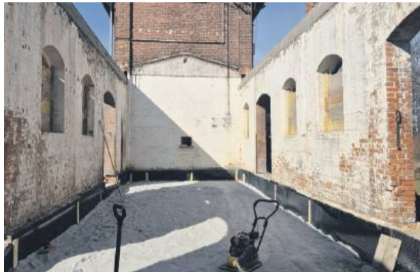
Tak aktualnie wygląda wnętrze budynku po byłej stacji PKP w Kondratowicach
