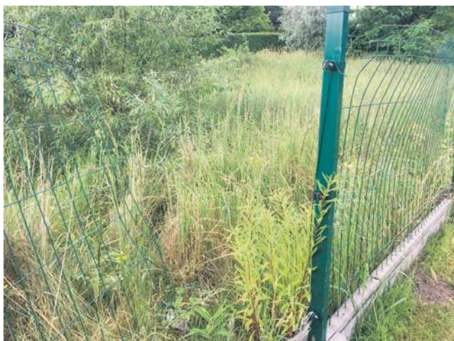
Zniszczone ogrodzenie boiska w Myślachowicach
