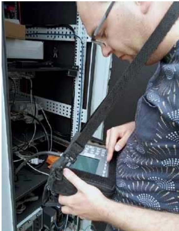
Wnętrze szafy SR5MS
