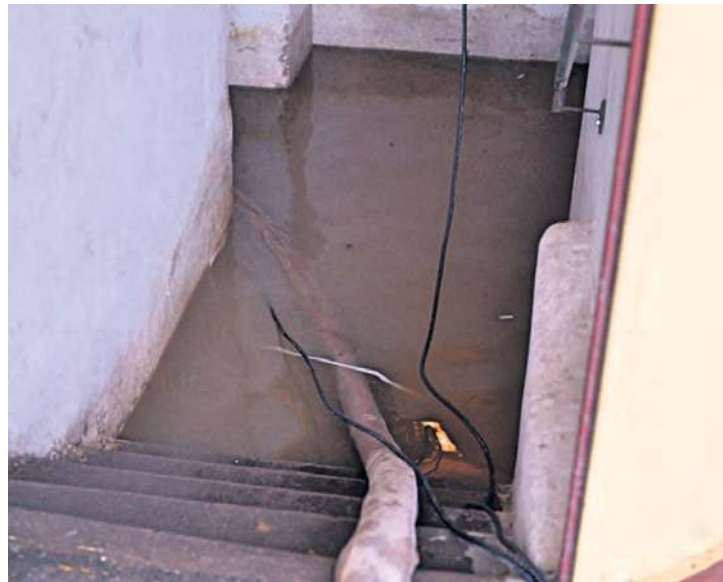
Kompletnie zalany blok w Kamienicy. Wszystkie piwnice pod wodą.
