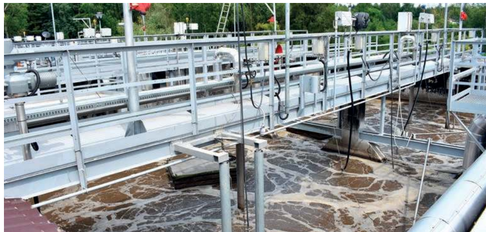
Oczyszczalnia ścieków w Libiążu. FOT. WODOCIĄGI CHRZANOWSKIE
