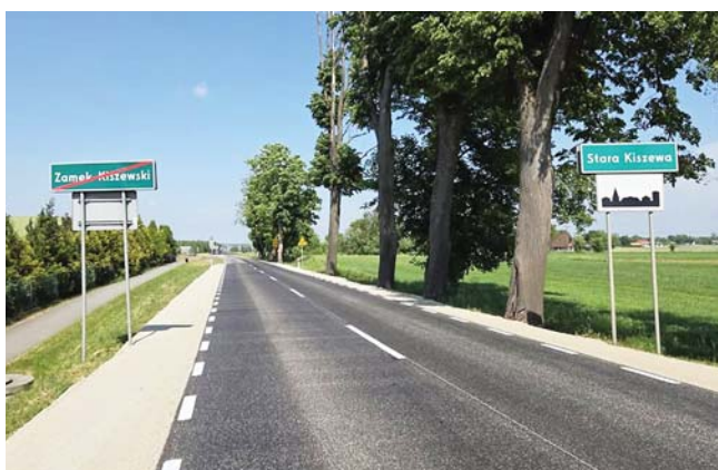
Prace objęły około 3,2-kilometrowy odcinek drogi, który od dłuższego czasu wymagał modernizacji.
