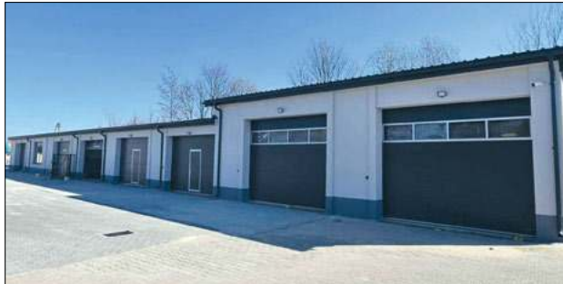
Drugi etap prac polegał na remoncie budynku garażowego, wykonaniu wagi najazdowej i nowego obiektu punktu selektywnej zbiórki odpadów komunalnych
