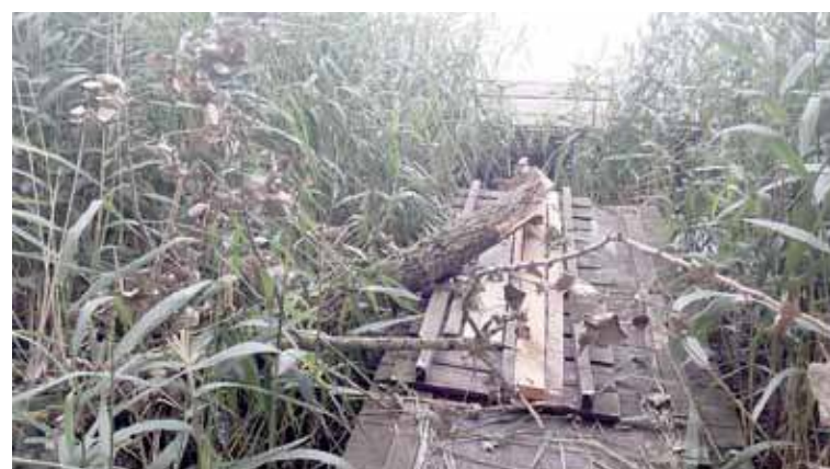
Ułamany spory konar topoli spadł wprost na kładkę. Na szczęście tym razem nikt nie ucierpiał
