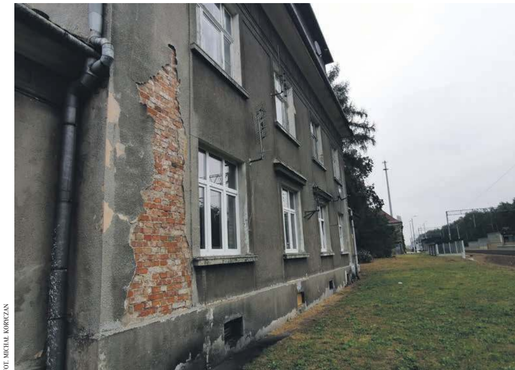
Odpadający tynk odkrywa ceglane mury budynku
