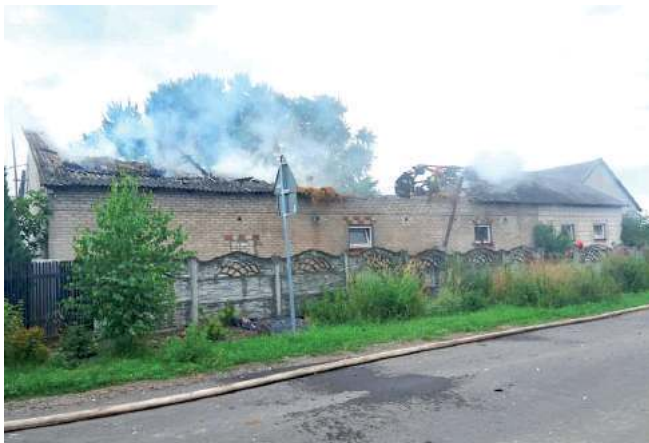
Kosuty: Całkowitemu zniszczeniu uległ dach obory i murowane szczyty. (fot. OSP Krzywda)
